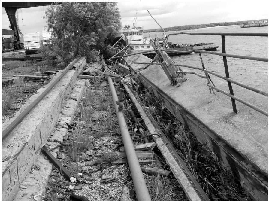
Рисунок 1 – Наклон железобетонного шапочного бруса в сторону территории
