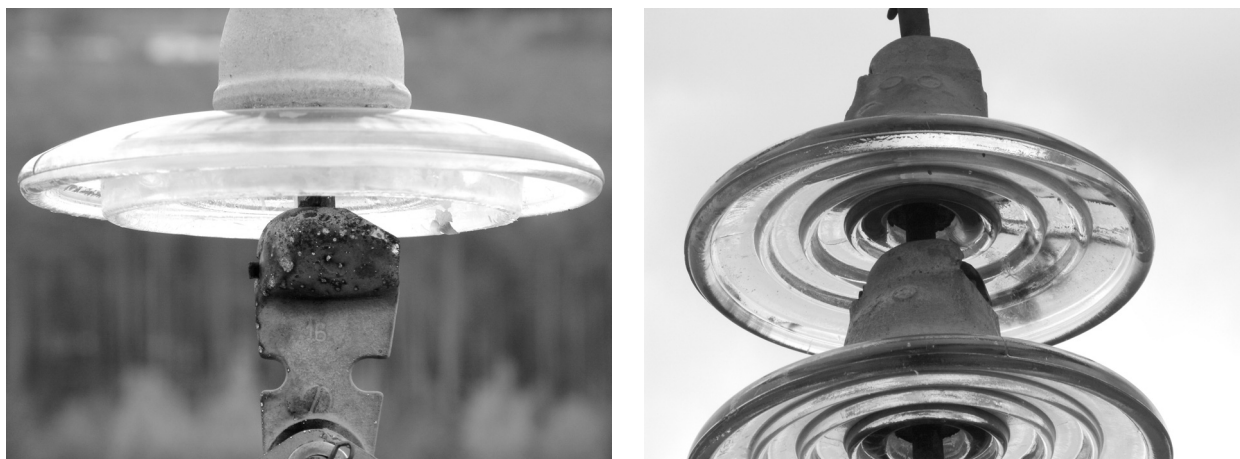
Рисунок 1 – Следы перекрытия на нижнем и верхнем изоляторах гирлянды на опоре №1 отпайки на ПС Форпост ВЛ-110 кВ «Полоцкая-Конденсат»
