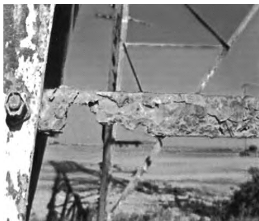
Рисунок 4 – Коррозионное разрушение металлической опоры
