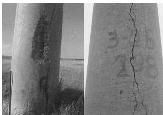
Рисунок 3 – Типичные дефекты центрифугированных стоек
