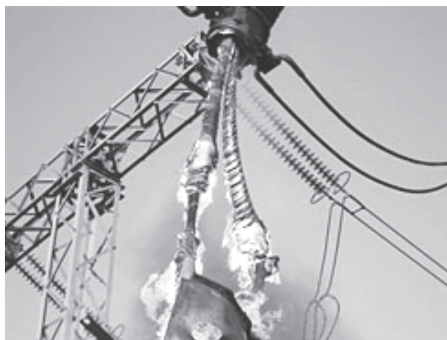
Рисунок 1 – Взрыв трансформатора тока ИМВ 362
