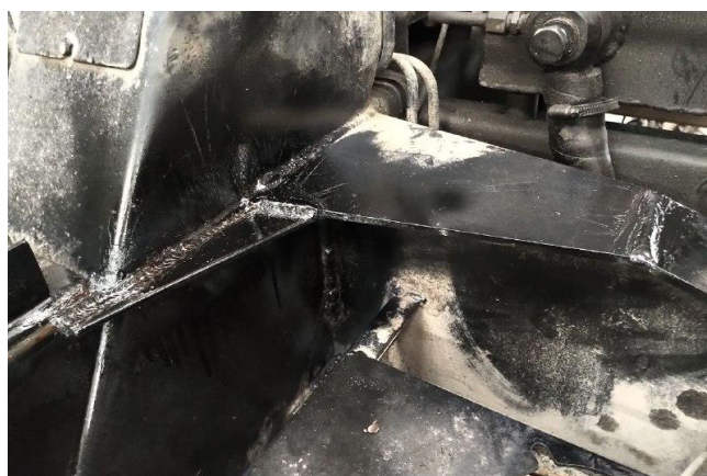
Рисунок 2 – Трещина по сварному шву с переходом на основной металл после ремонта, с установкой элемента усиления в виде косынки
